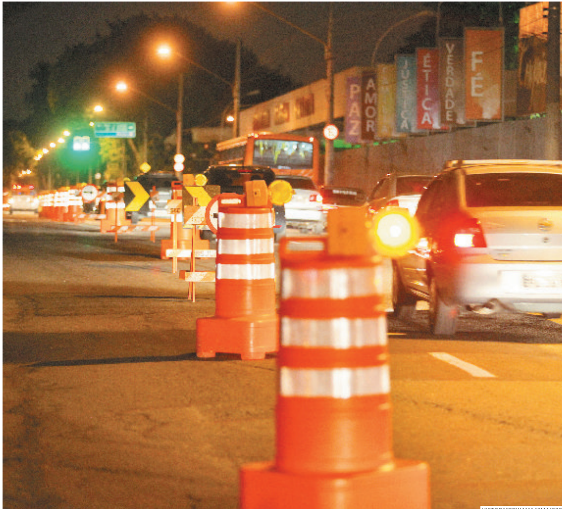
Acesso à marginal da Dutra na altura do km 150, interditado desde maio para obras em trecho da avenida Jorge Zarur; a NovaDutra chegou a considerar o fechamento permanente do local
